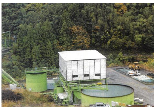
濁水処理設備設置例
